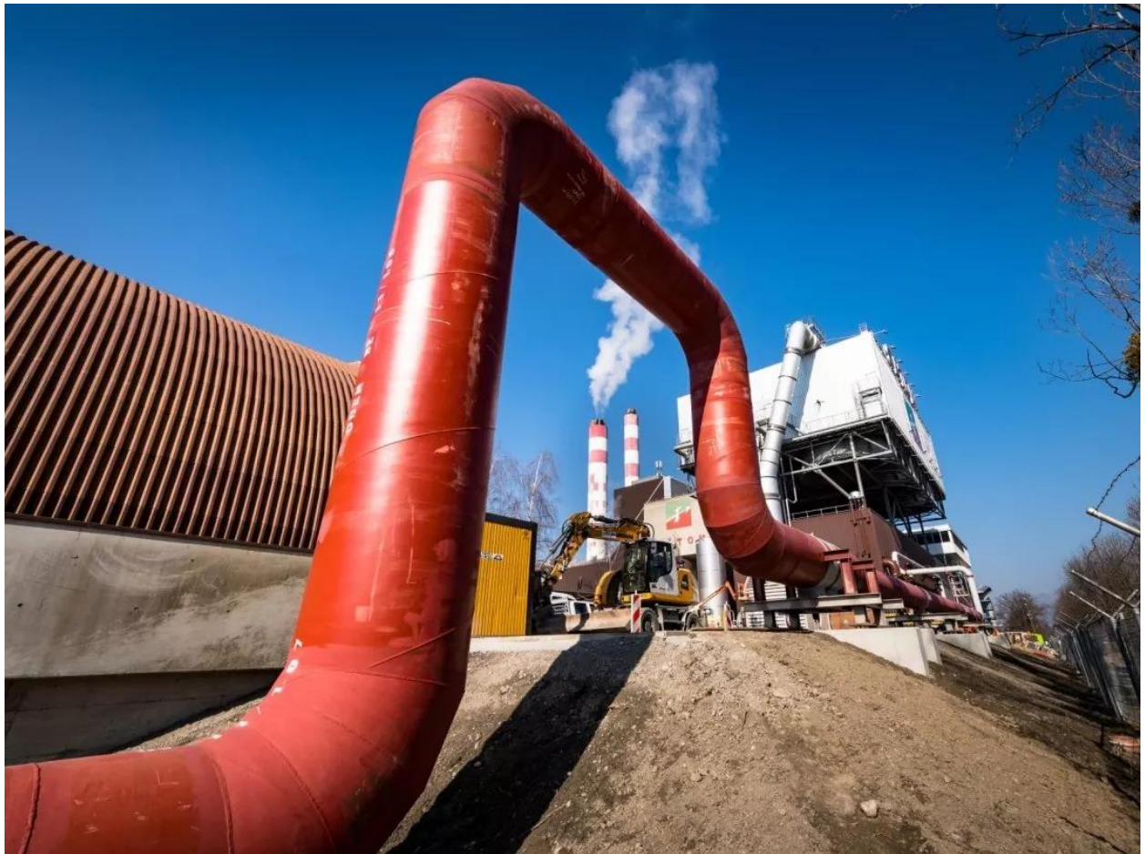
Abbildung 1: Die neue Dampfleitung Ecotube der Satom (KVA Monthey) wurde 2022 in Betrieb genommen. Die Satom versorgt damit den Chemiebetrieb CIMO mit Dampf. Im Jahr 2023 wurde eine Energiemenge von über 110 GWh geliefert. (Bildquelle: Le Nouvelliste).
